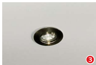
Подключение точечного светильника
